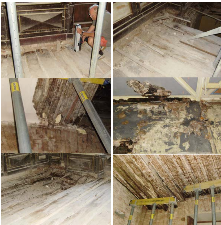
Obr. 6: Ukážky: (a, b, c) Strop nad miestnosťou 1.20 – zjavne hnilé záhlavia trámov č. 1 – 6 s vrtnom do trámu č. 7, pričom hnilé boli aj záhlavia trámov č. 28-32 pri prepadnutej časti stropu, na ktorých od spodku vyrastali plodnice huby Antrodia vaillantii ; (d) Mokrý múr pri strope nad miestnosťou 1.09 – plodnice huby Serpula lacrymans pod pätkami trámov č. 19-24; (e, f) Strop nad miestnosťou 1.21 – hnilé a z múru uvoľnené trámy č. 1 – 6, v ktorých aktívne pôsobila huba Antrodia vaillantii .
